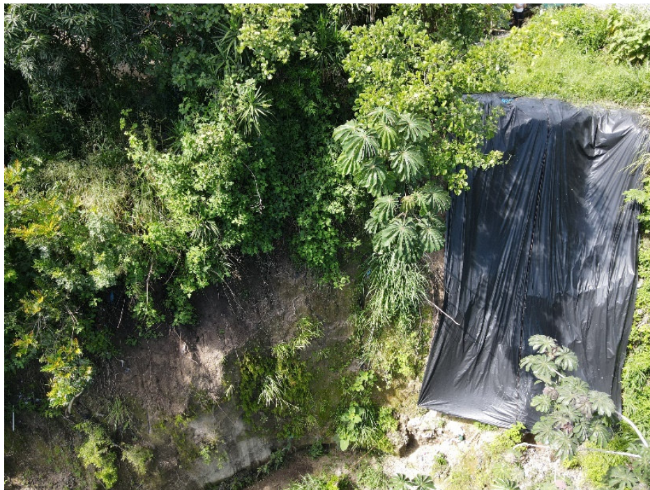
Imagen 1. Problemática de erosión
