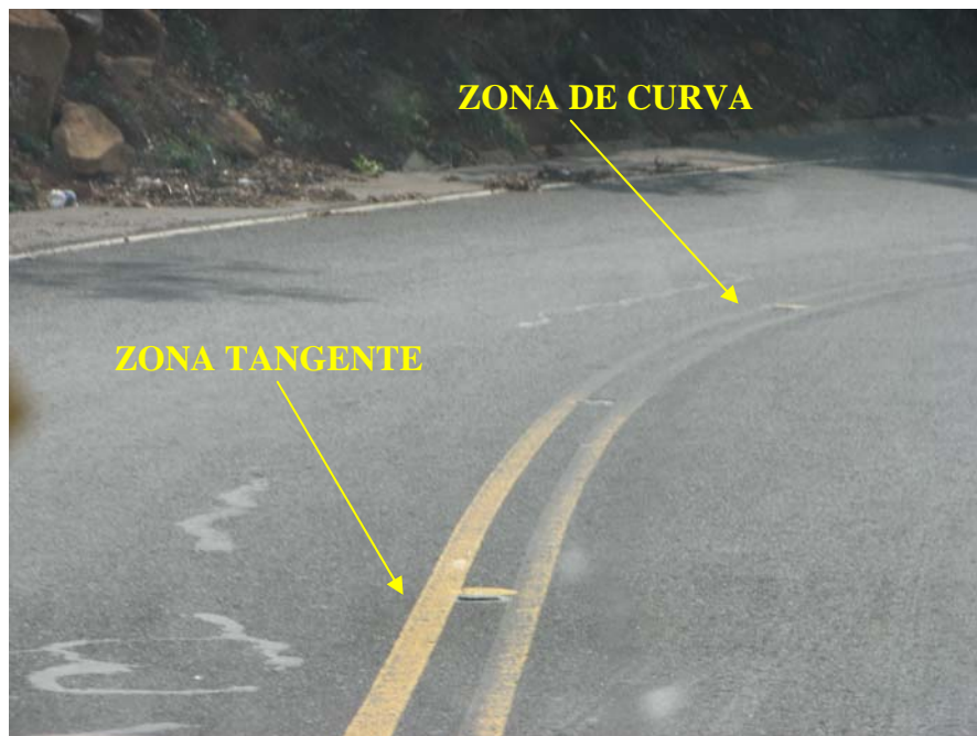
Fotografía 5. Desgaste de la señalización en zona de curva debido al paso continuo de los neumáticos de los vehículos [Ministerio de Obras Públicas de El Salvador, Carretera Panamericana CA-01].
