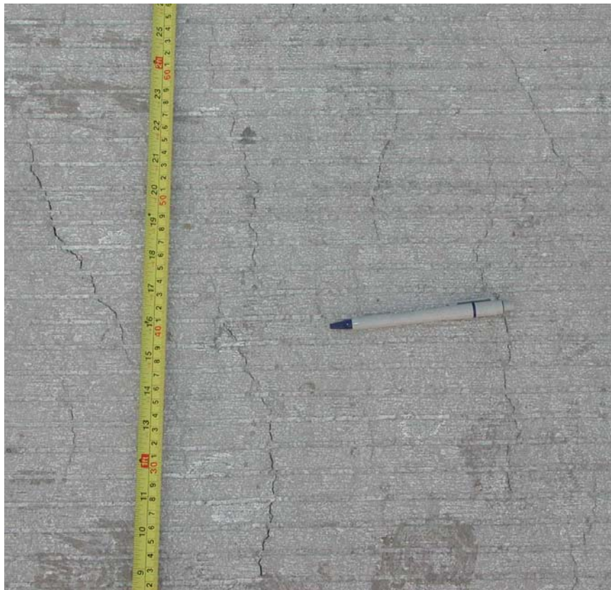
Fig. No.5. Grietas por Contracción Plástica. Losa de concreto en Pavimento.
