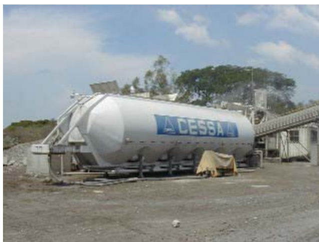
Foto 5. Planta Florencia, Autopista S.S-Comalapa-Aeropuerto. Silo horizontal para el almacenamiento del cemento a granel.
